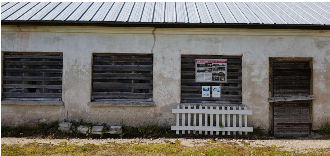
Pihan puoleinen (idän puoleinen) julkisivu. Pihan puolella on suuret ikkunat. Julkisivun yläosassa räystäään alla on muuratut koristelistat.
