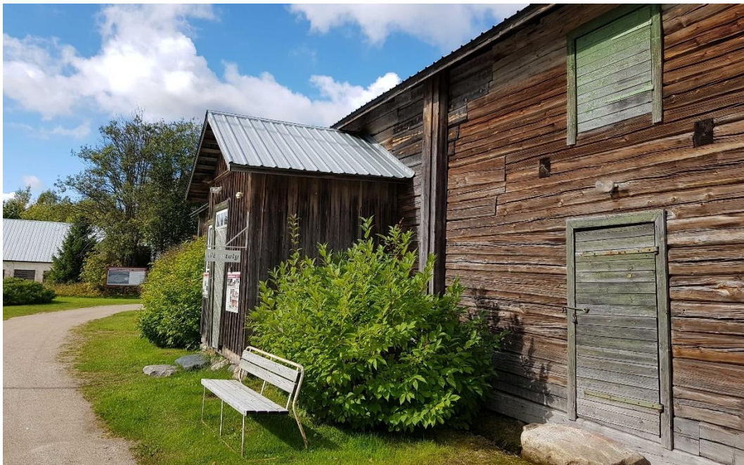
Pikkupirtin hirsiseinissä näkyy eri aikoina tehtyjen korjausten jälkiä.
