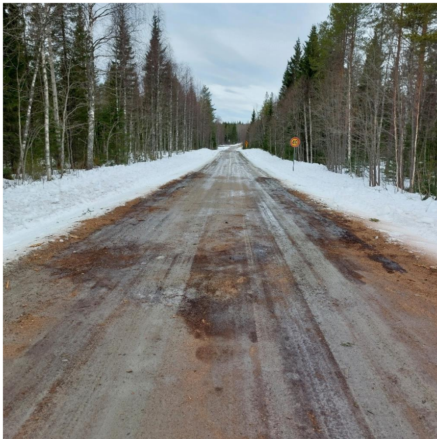
Kuva 1. Yleiskuva öljyvahingon laajuudesta tiellä.
